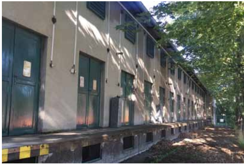
Pohled na skříňové rozvaděče
