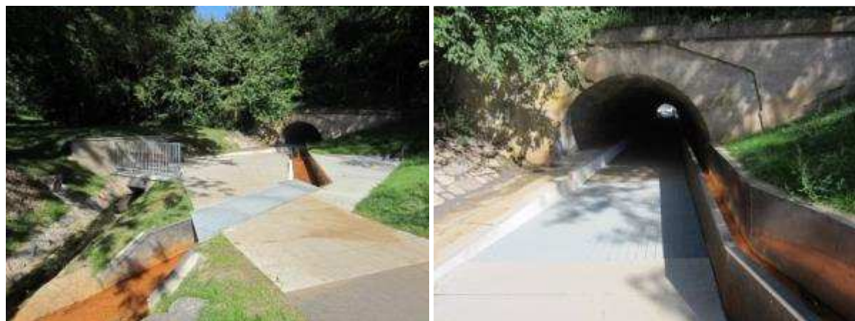
Zbarvení vody způsobeno výluhem z výsypky
